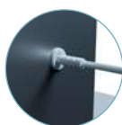
Système de passe-câble
